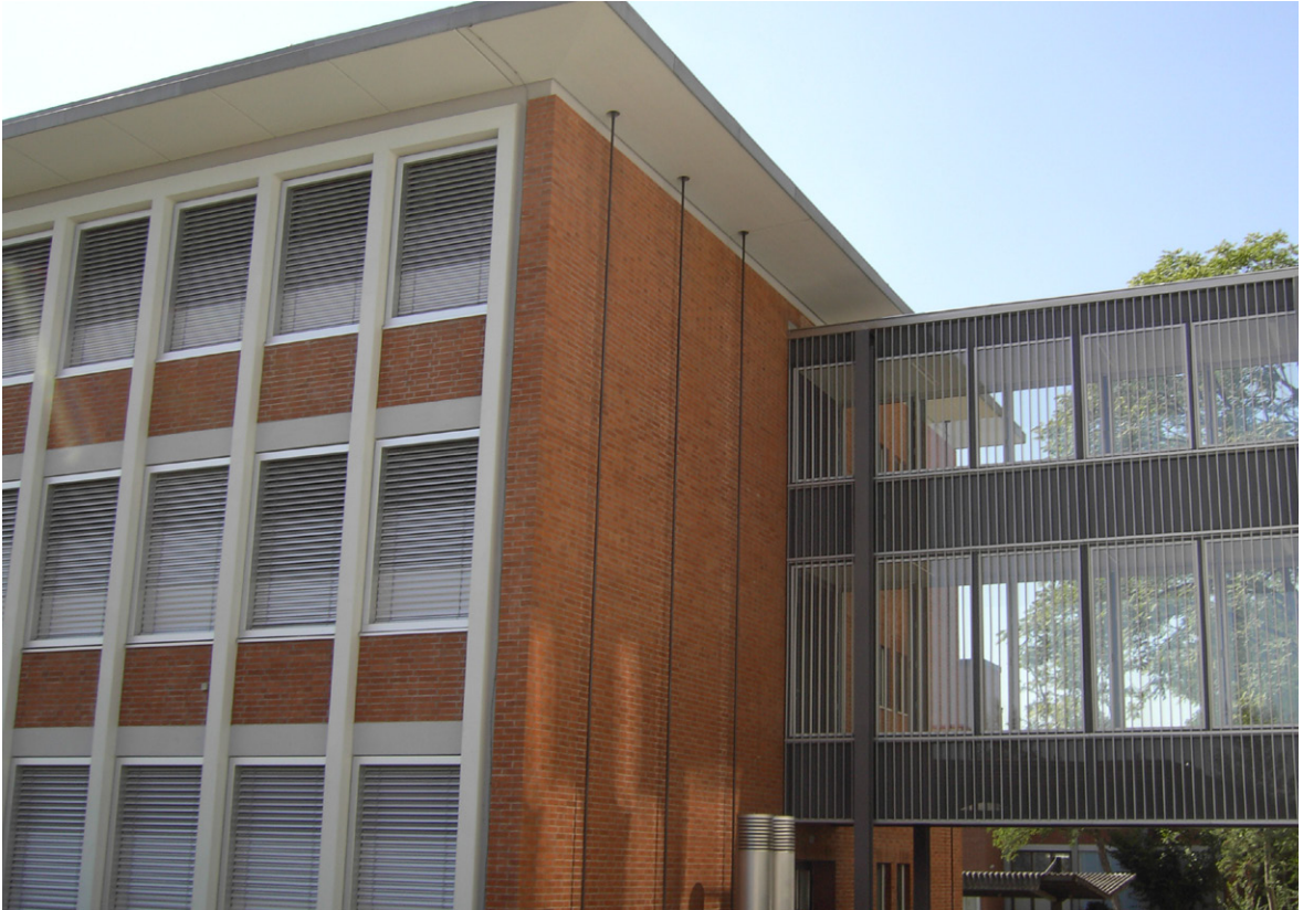
Die CFK-Spannglieder (schwarze Stangen in der Bildmitte) beim Empa-Verwaltungsgebäude wurden ausserhalb der Stirnfassade angeordnet, um sie jederzeit inspizieren zu können.
